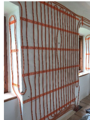
Przykład ogrzewania ściennego w starym budynku
